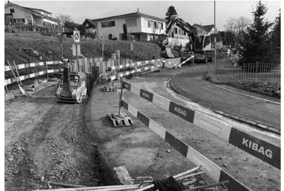
Aufgrund der positiv verlaufenen Gemeindeabstimmung konnte am 22. Januar 2024 mit dem Sanierungsprojekt «Im Wygärtli» gestartet werden. Bild: Gemeindeverwaltung
