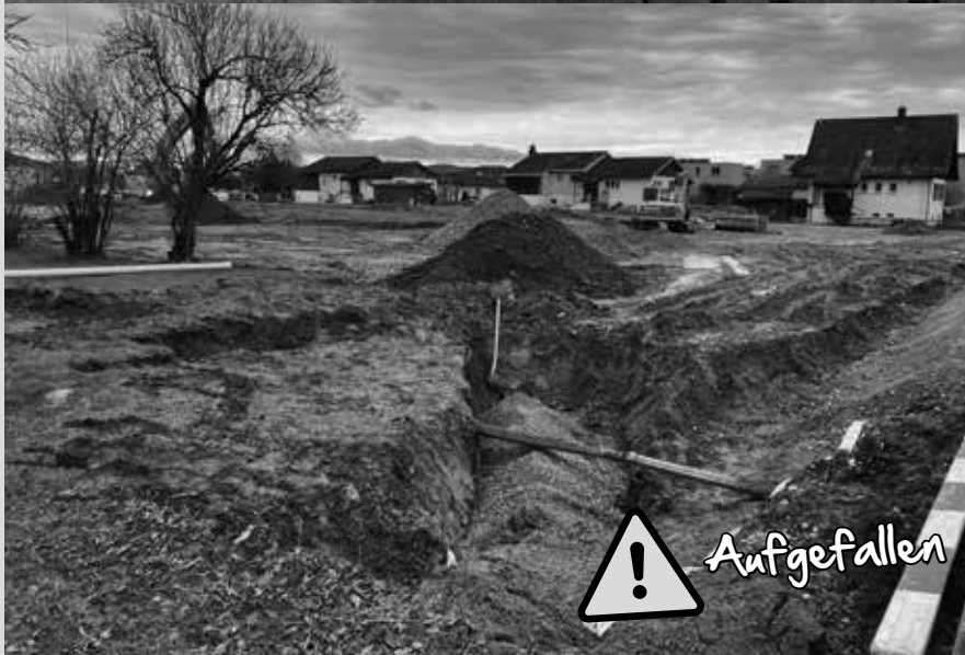
An der Kreuzlinger- und an der Bahnhofstrasse haben die Bauarbeiten begonnen für zukünftige Wohnungen.
