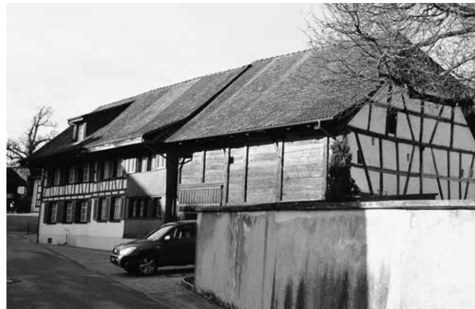
Der sanierungsbedürftige südliche Teil des Daches über dem Kirchgemeindehaus.
